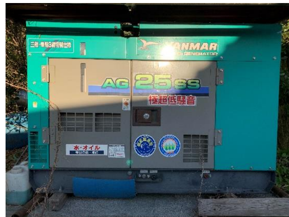
図8-4 自家発電装置
